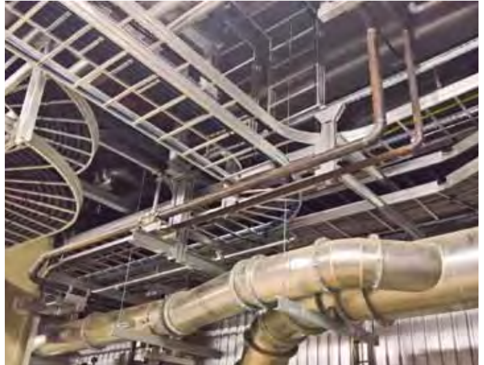
Rowa-Moser bietet auch für die Installation der Kabelpritschen sein bewährtes Montageservice an
