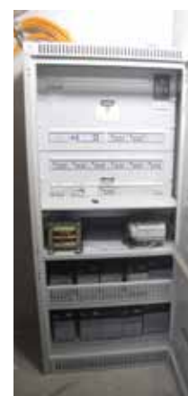
Die Anlagensteuerung befindet sich in einem eigenen Raum
