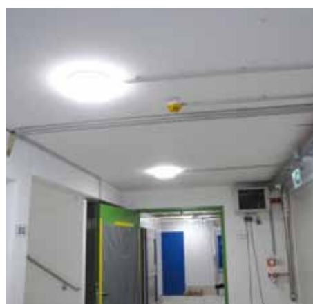
Im Storage-Gebäude in Wien im Einsatz: LOTOS Elegance-Leuchten in runder Ausführung, die einen sehr guten Ausleuchtungsgrad bieten
