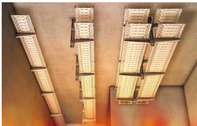
Funktionserhalt von Kabelanlagen: mit ROWA-MOSER, PUK und Dätwyler sicher und wirtschaftlich
